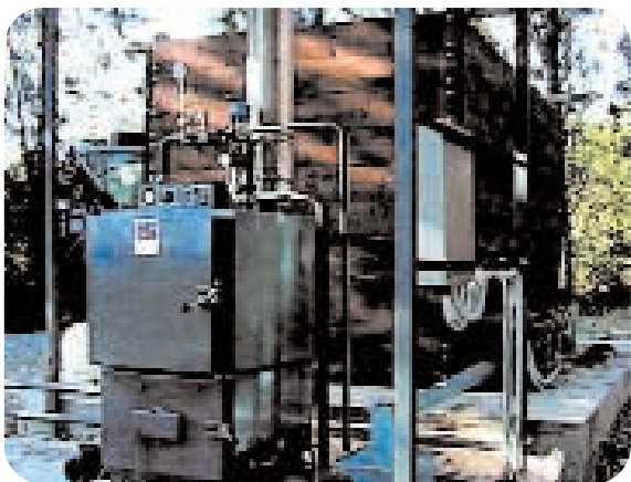
Figura 3. Caldaia a cippato di legna
