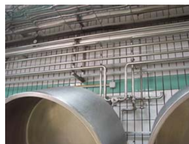
particolare tubazioni di adduzione (vapore, acqua, latte) al locale lavorazioni
