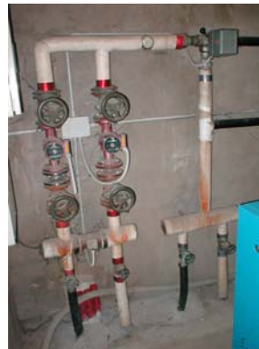
Particolare dei collettori
