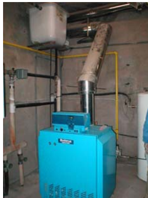
Il generatore di calore
