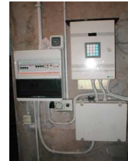
Particolare del quadro elettrico
