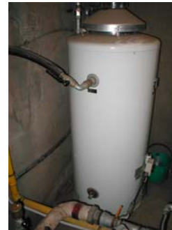
Particolare del boiler
