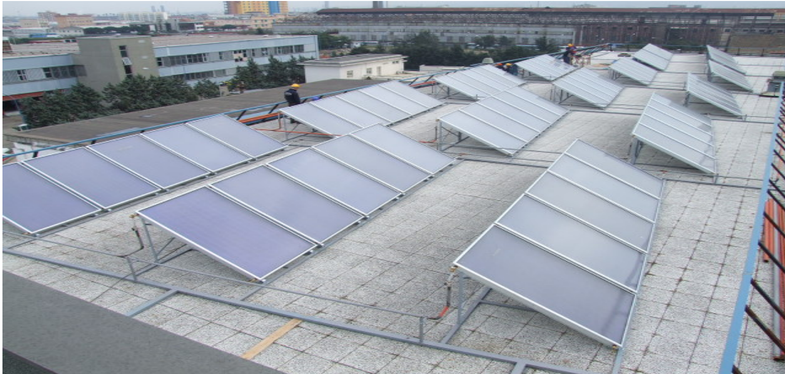
I pannelli solari installati sul terrazzo
